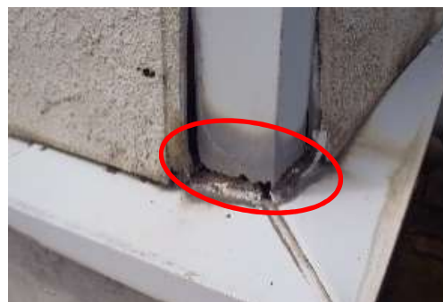
外壁鉄骨の断裂
